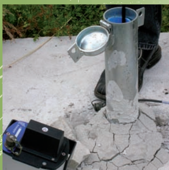
Instrumentation de piézomètres pour les mesures de niveau d'eau
