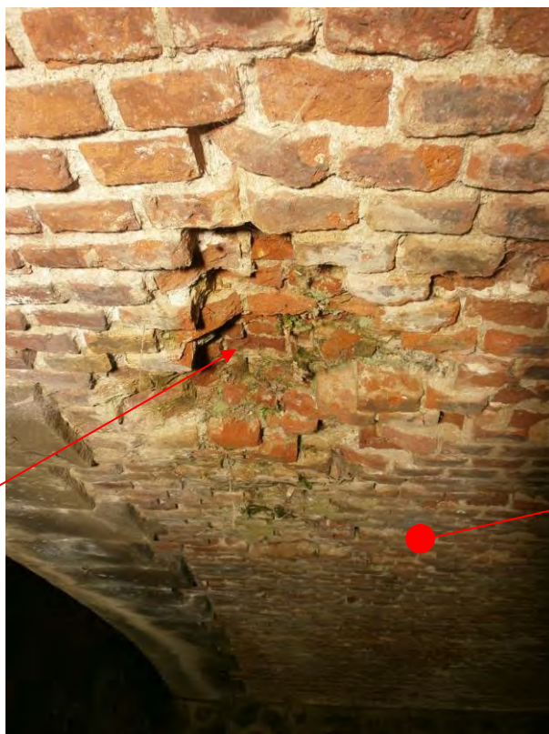
Photo 2 : PRO KM 498+730 - Désordres constatés
